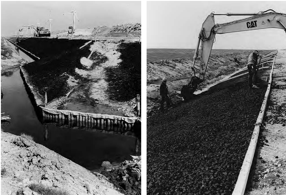
Abb. G 50b+c: Deichverstärkung Friedrich-Wilhelm-Lübke-Koog hinter Vorland 2001/2002: Einbau von Mastixschotter als Fußdeckwerk auf Bitumensand-Filter bis zur Überschlagssicherung
