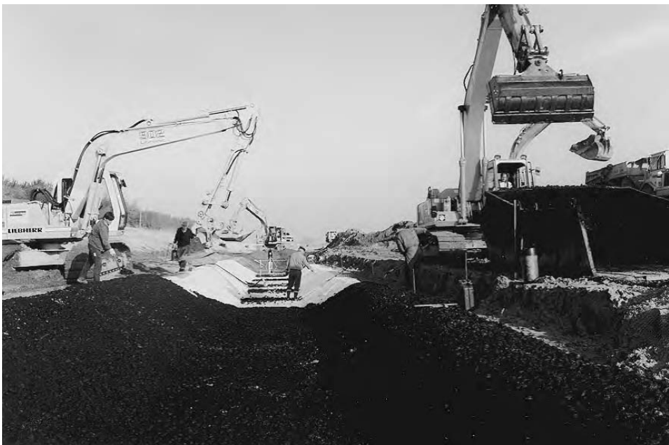
Abb. G 55a: Deich im Tidebereich des Elbe-Ästuars bei Glückstadt mit höherem Vorland, deshalb mit einem wasserseitigen Entwässerungsgraben mit einem erosionsfesten offenen Deckwerk aus Mastixgestein auf geotextilem Filter zur schnelleren Wasserabführung
